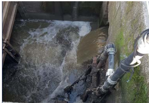
Ingresso del refluo urbano all'impianto di depurazione
