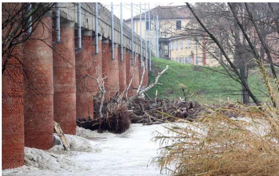
Figura 11. Esempio di formazione di un filtro costituito da detriti in corrispondenza dei piloni di un ponte (foto di A. Valente)
