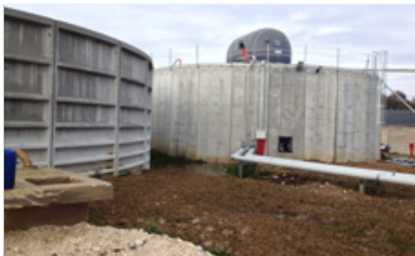
Foto 1 - Digestore di un impianto per la produzione di biogas
