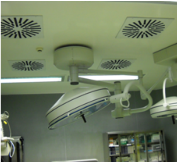
Diffusori a flusso elicoidale in sala operatoria
