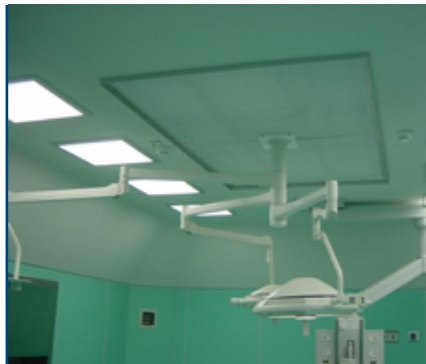
Diffusori a flusso laminare in sala operatoria
