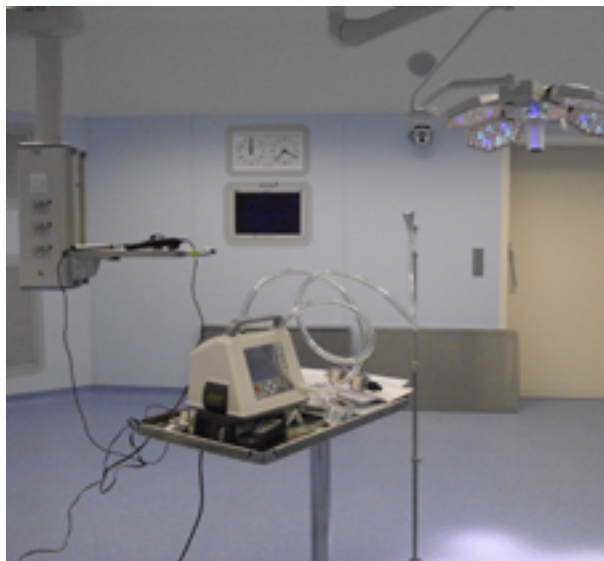
Controlli in sala operatoria: la conta particellare
