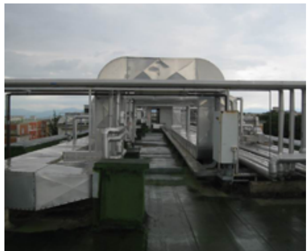
Unità di trattamento aria di un ospedale
