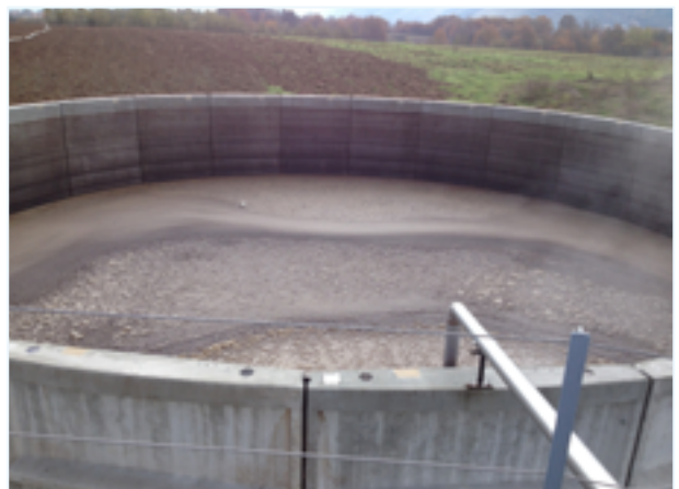
Foto 3 - Area di stoccaggio del digestato liquido prodotto in un impianto per la produzione di biogas
