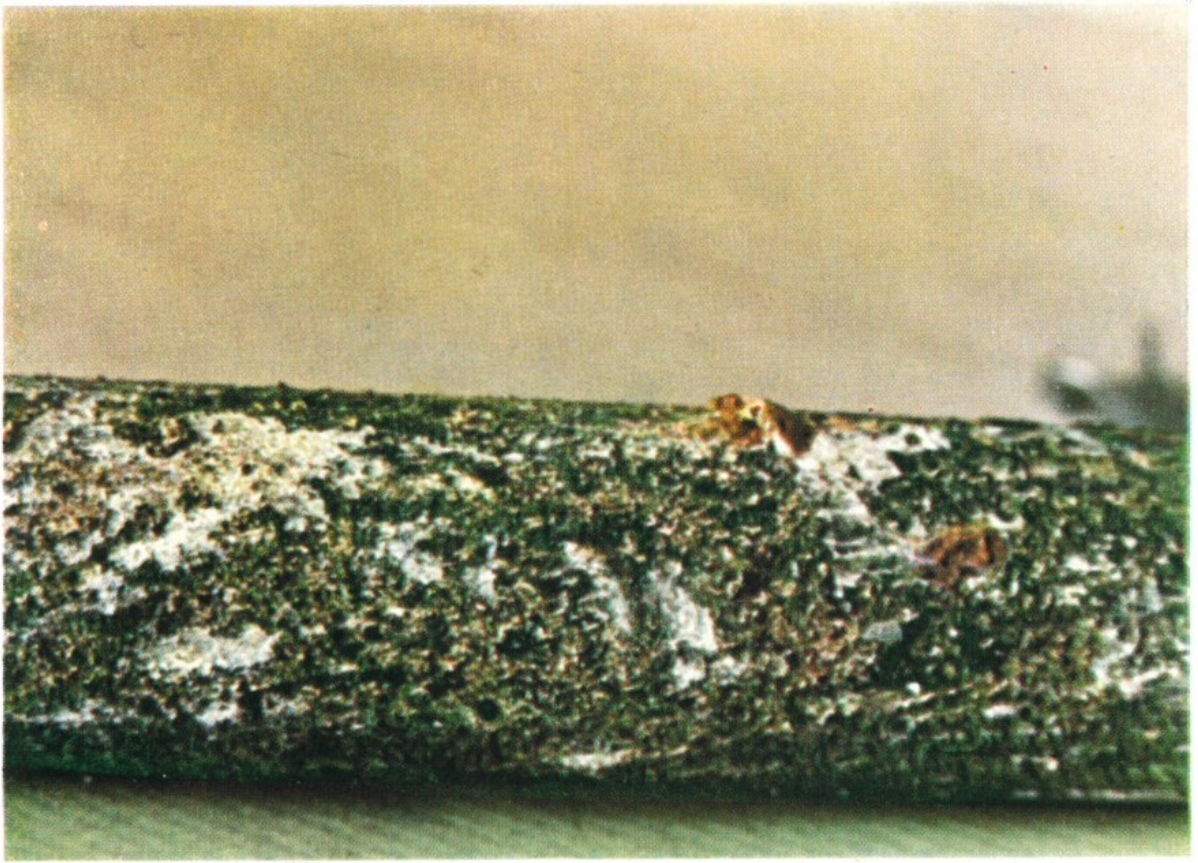
Fig. 1. - Spezzone di tubazione di acciaio perforata da corrente dispersa in terreno argilloso.
