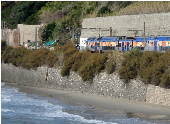
Figura 3. Spiaggia delle Calandre (Ventimiglia), sulla quale è stato costruito il muro di retta della sede ferroviaria, è estremamente stretta e a debole pendenza, e molto spesso sparisce completamente
