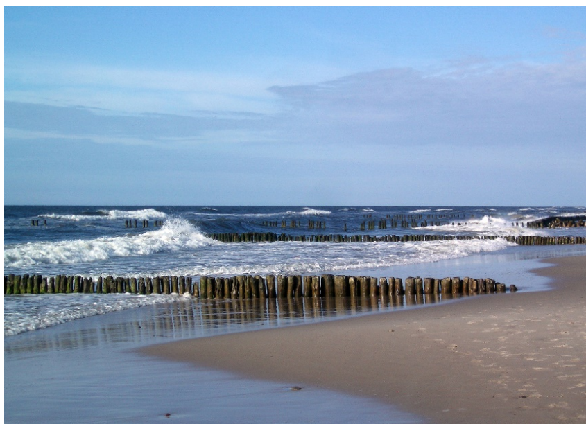
Figura 15. Pennelli permeabili sulla costa della Polonia
