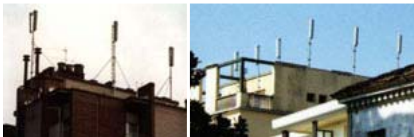
Figura 8. Esempi di BTS installate sopra i palazzi (roof top)
